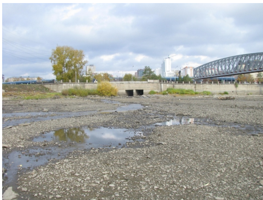
Отложения у выхода коллектора в устье Каменки
